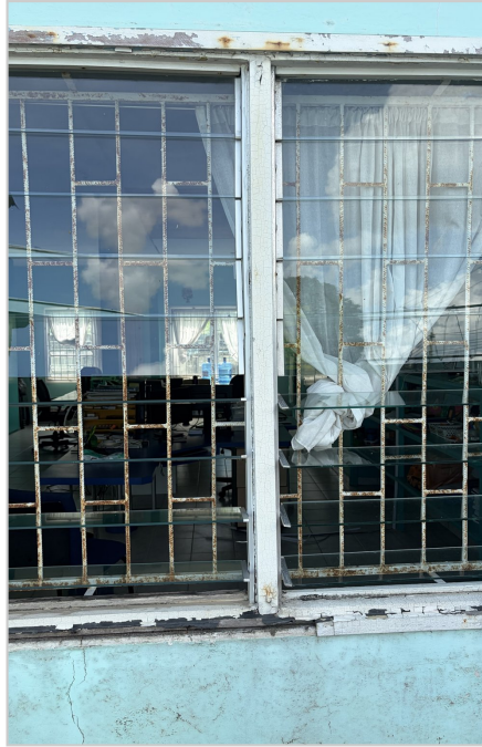
Ramen en traliewerk met roest en afbladderende verf
