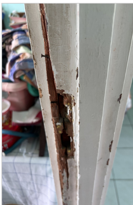
Aangetaste deurpost met zichtbaar houtrot
