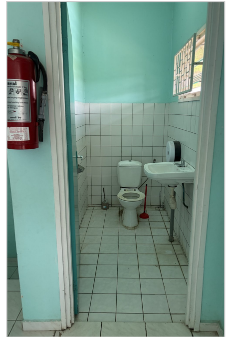
Sanitair dat aan vervanging toe is
