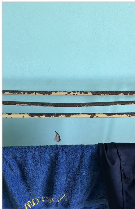
Roestig kledingrek in de slaapkamer
