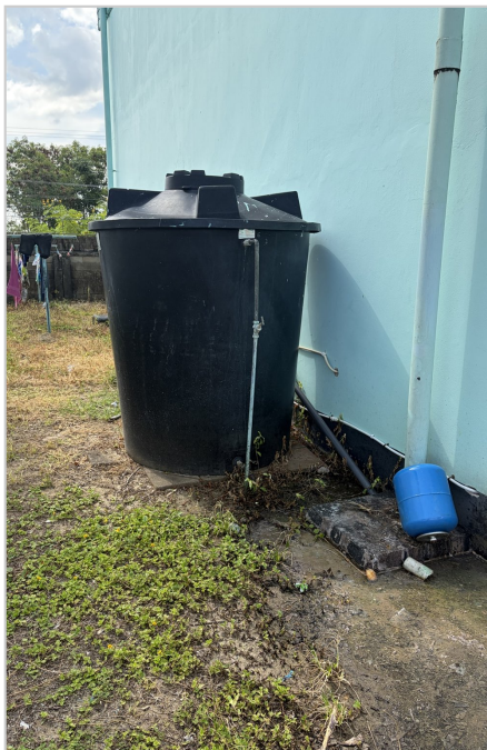
Watertank en leidingen aan de buitenzijde
