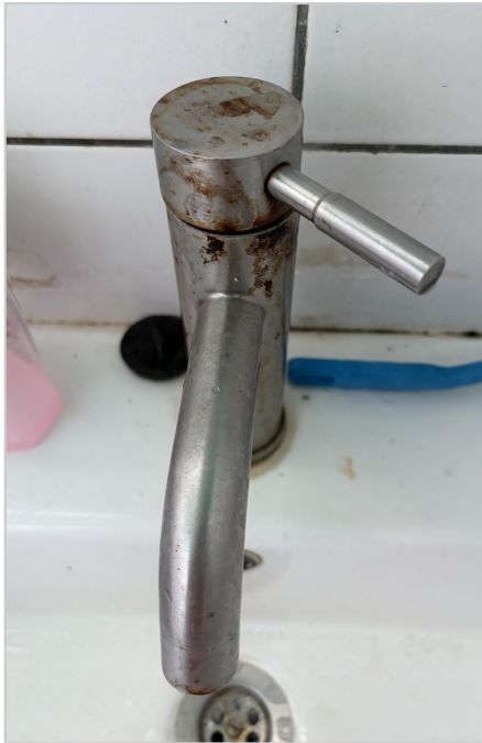
Verroeste kraan: kranen moeten vervangen worden
