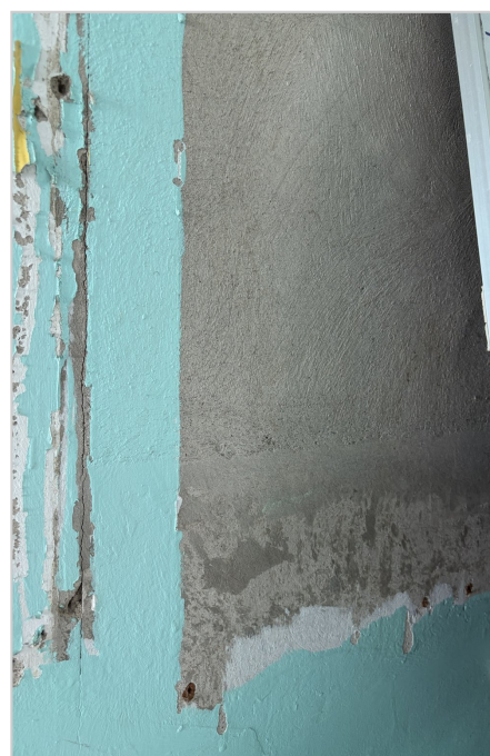
Muren met scheuren en loslatende verf
