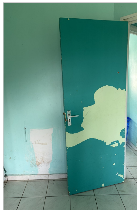
Deur en muur die aan herstel toe zijn
