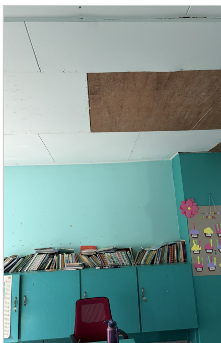
Beschadigd plafond in de leefruimte
