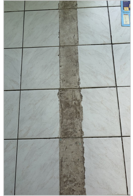
Vloer met ontbrekende tegels
