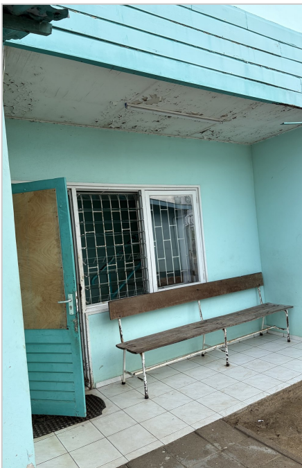
Ingang met afbladderend plafond
