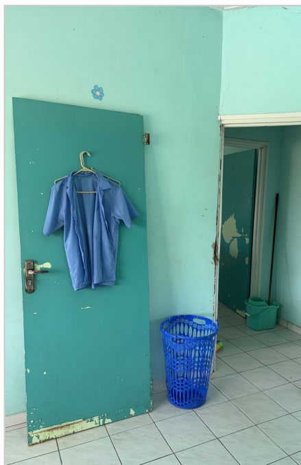
Deuren met afbladderende verf en roest
